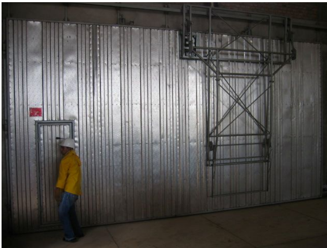
FOTO 7.21. Horno de las instalaciones de San Ignacio durante un proceso de secado
