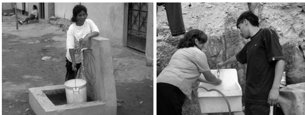
Instalación de pilón comunal en la localidad César Vallejo en El Agustino (izquierda) e instalación de agua definitiva en localidad Las Malvinas en Santa Anita.
